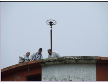
PARAFULMINE SU TORRE Foto di: ARPA Calabria Radionuclide: Provenienza:
