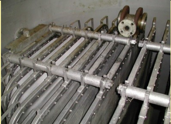
ELEMENTI FILTRANTI DI IMPIANTO INDUSTRIALE Foto di: ARPA Lombardia Radionuclide: NORM Provenienza:
